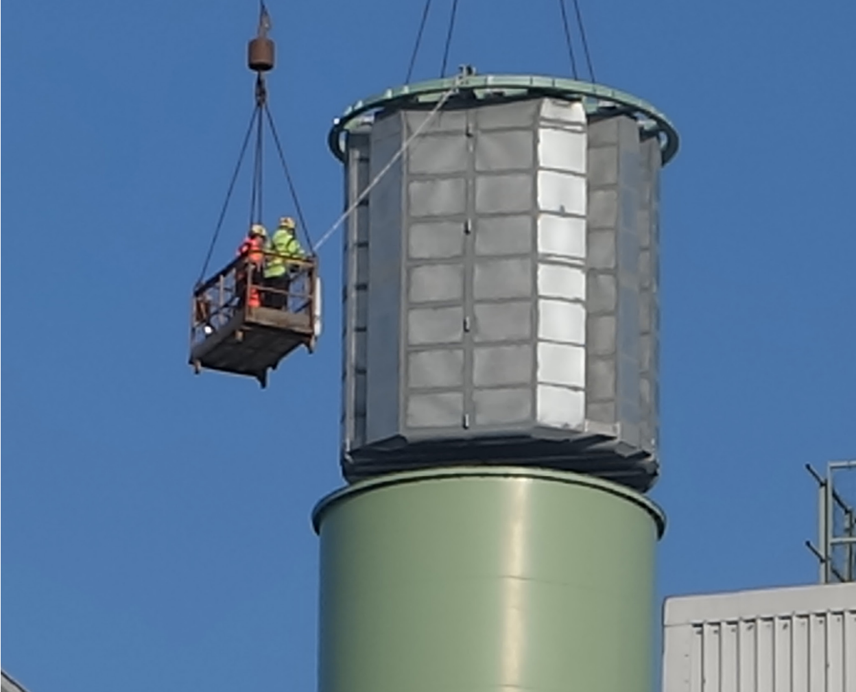
Hljóðdeyfir settur í stromp nýrrar þurrhrensistöðvar.
